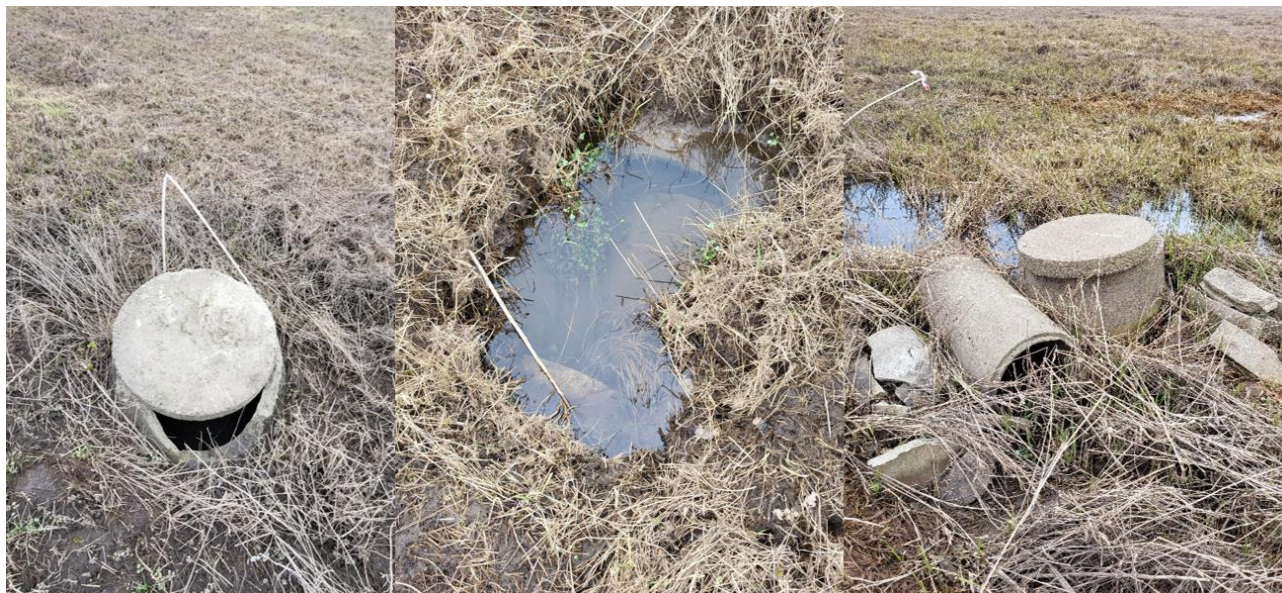
Billede 3.2.3-5 Enkelte brønde er beskadiget og der er ses jordfaldshuller omkring og mellem brøndene.
