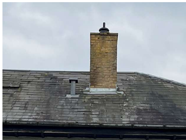
Foto 14: Skader på eternitskifer ved skorsten
