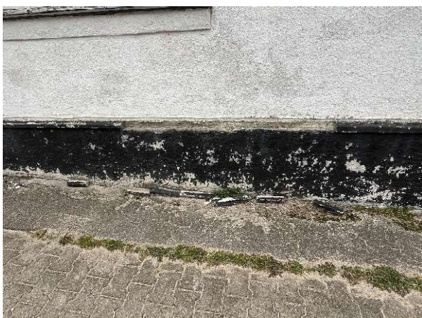
Foto 11: Afskallet sokkel mod gade
