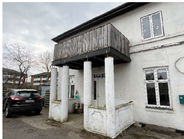
Foto 6: Altan ved gavl og hoveddør
