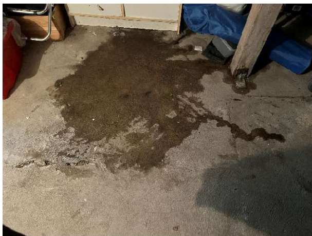
Foto 3: Kældergulv med vand fra utæt vindue
