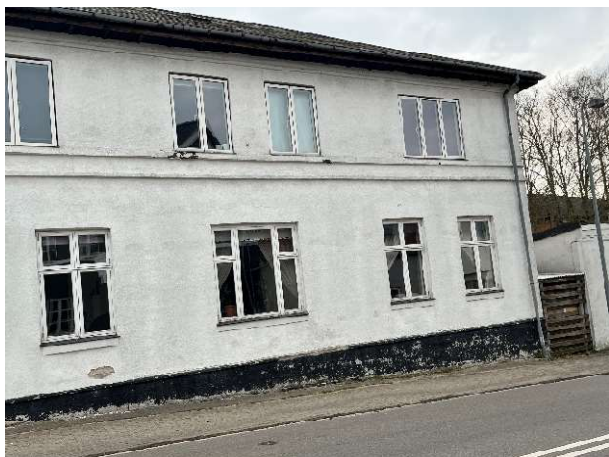
Foto 13: Afskalninger og nedbrudt facade mod gade
