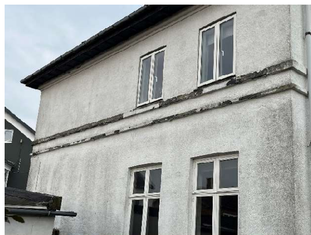
Foto 12: Afskallet puds på gesimser på gavl
