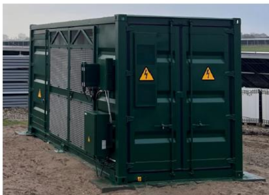
Fotoeksempel af MVS6400-LVcontainer/inverter
