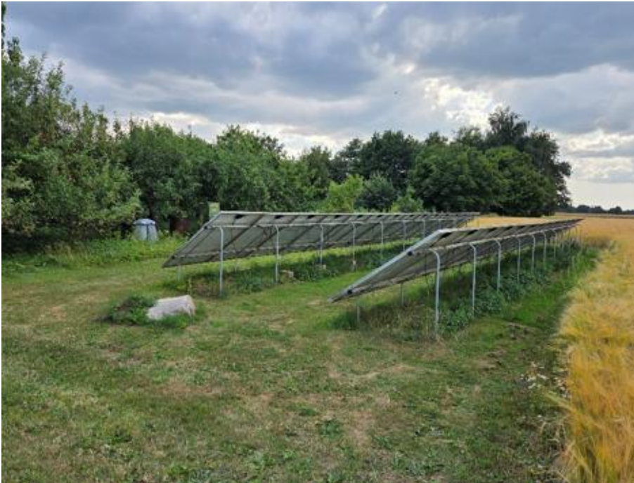
Solcelleanlægget set fra nordøst. Fra ansøgningsmaterialet.
